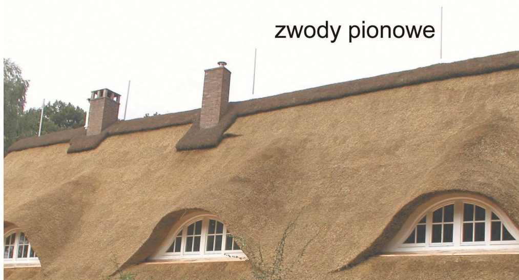
Rys. 1. Zwody podwyższone na dachach krytych słomą lub łatwopalnym materiałem, a) typowa instalacja ułożona ponad powierzchnią dachu, b) zastosowanie zwodów pionowych połączonych z przewodami o izolacji wysokonapięciowej
