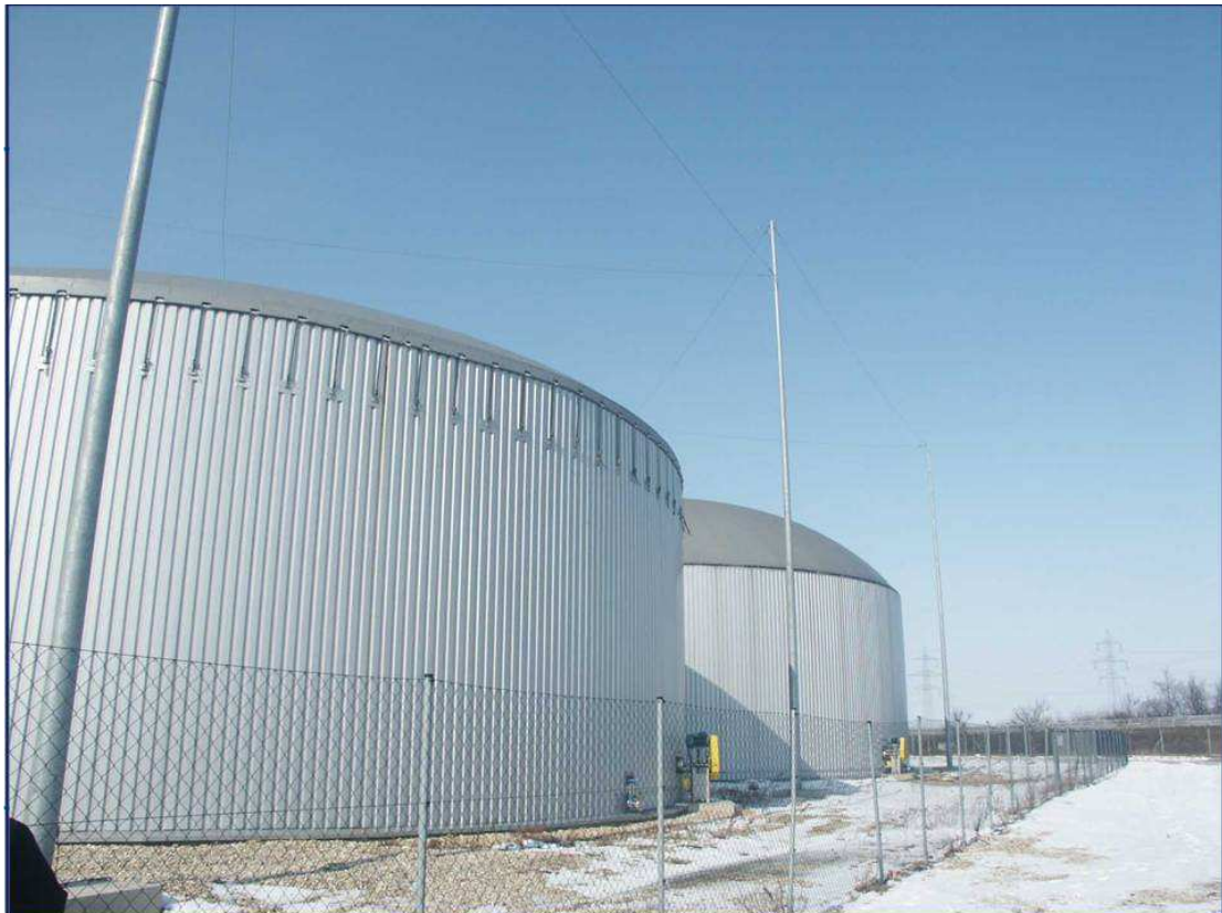
Rys. 4. Ochrona odgromowa zbiorników o grubości ścianek mniejszej od wymaganej
